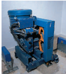
13. MAQUINARIA DE ASCENSOR.
