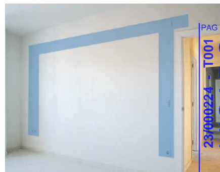
24. Bandas por donde discurren las instalaciones. Salón.
