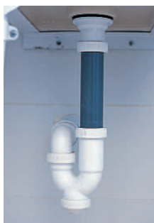
9. SIFÓN REGISTRABLE DEL FREGADERO.
