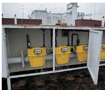
20. BATERÍA DE CONTADORES Y LLAVES DE CORTE.
