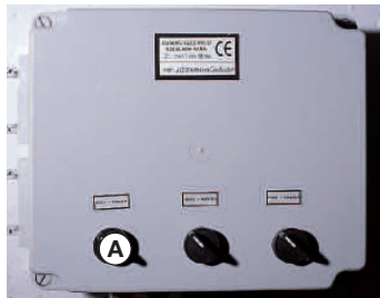
5. CUADRO DE MANDO DE ELECTROBOMBAS: A. Mando para-marcha.
